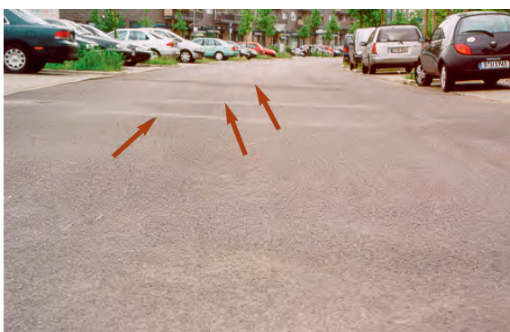
Wellenbildung (hier bei einer Wohnstraße) durch Anhydrit/Gips-enhaltende Materialien in den Schichten ohne Bindemittel
