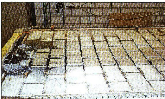
Bild 2: Spurrinne und nach oben „gepumptes“ Fugen- und Bettungsmaterial
